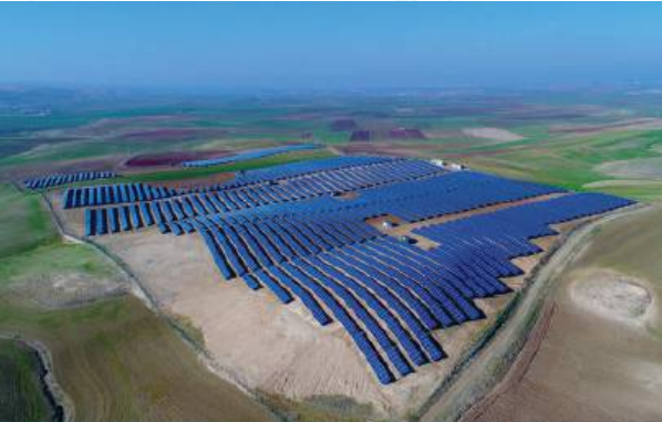
BATMAN BEŞİRİ 6.6 MWp - 2016
